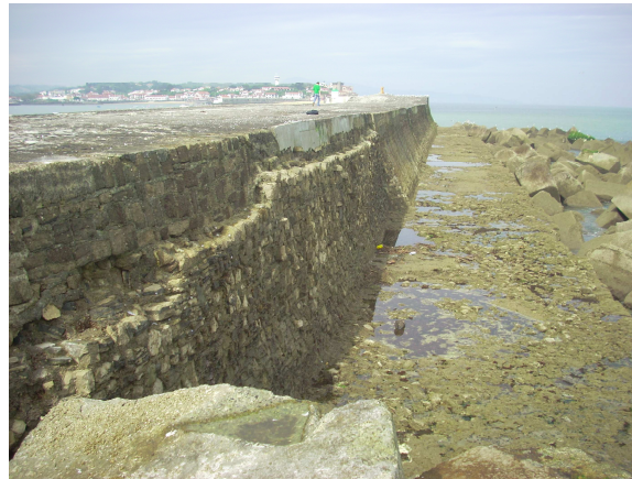
Endommagement local maçonnerie
