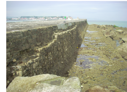
Endommagement local maçonnerie
